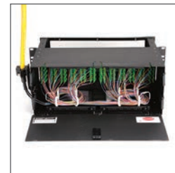
Gabinete Eclipse 4U con Cables
